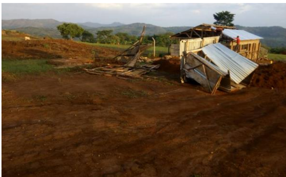
Die zerstörte Toilette
