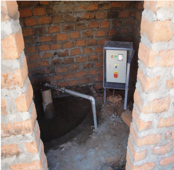
Die neue Wasserpumpe
